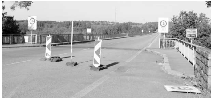
ŽDÁKOVSKÝ MOST. Při vjezdu na most ve směru od Kostelce nad Vltavou musí od roku 2009 vjíždět řidiči na chvíli do protisměru, pravá část mostu je vážně poškozená. Foto (2x): Deník/Stanislava Koblihová
